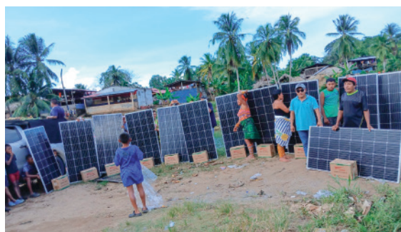
PANELES SOLARES. CORREGIMIENTO DE WARGANDÍ.
